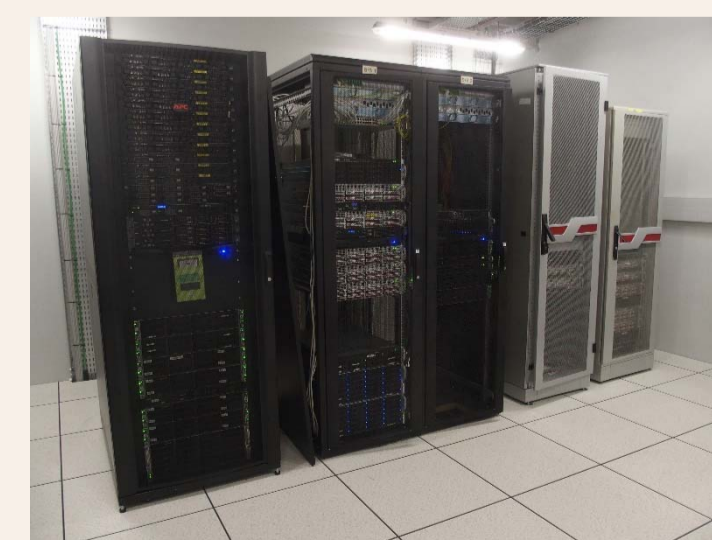
Salle des serveurs informatiques
